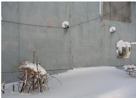
写真3 積雪により基礎被害の確認が困難
