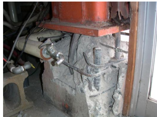
写真 3-2 基礎の著しい破損
