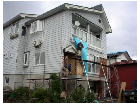
写真 2-21 サイディングの損傷(Bランク)
