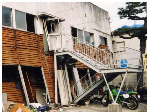
写真 2-23 屋外階段の傾斜被害(Cランク)
