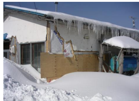
写真4 積雪により基礎被害等の確認が困難
