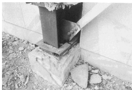
写真 3-9 柱脚コンクリートの部分破壊
