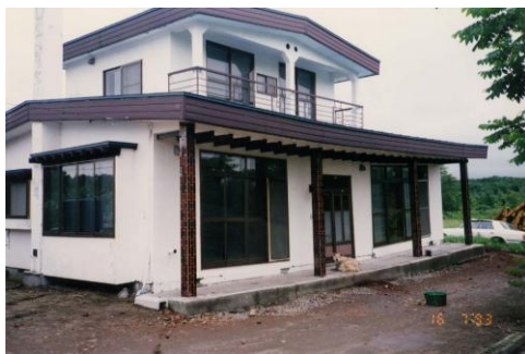
写真 2-5 建物の不同沈下(Bランク)
