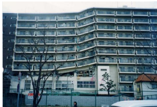
写真 4-14 構造躯体の損傷による部分的な傾斜
