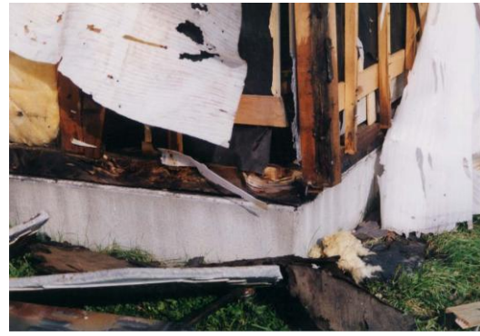
写真 2-13 土台、柱の腐朽 (C ランク)
