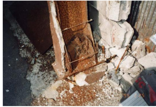
写真 3-11 柱脚の腐食 (C ランク)
