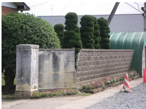
写真 2-24 ブロック塀の転倒危険(Cランク)
