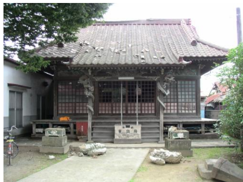
写真 2-15 棟瓦のズレ、損傷 (C ランク)
