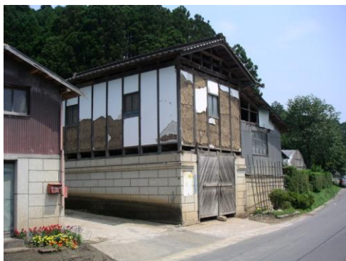
写真 2-18 土壁の剥落 (C ランク)
