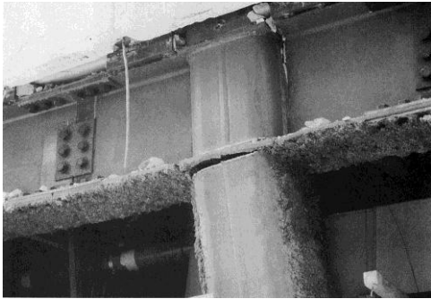
写真 3-6 柱頭での柱溶接部の破断
