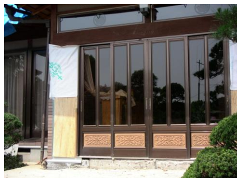
写真 2-17 玄関戸の歪み (B ランク)
