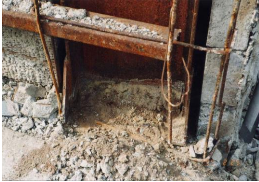
写真 3-10 柱と胴縁の腐食 (C ランク)
