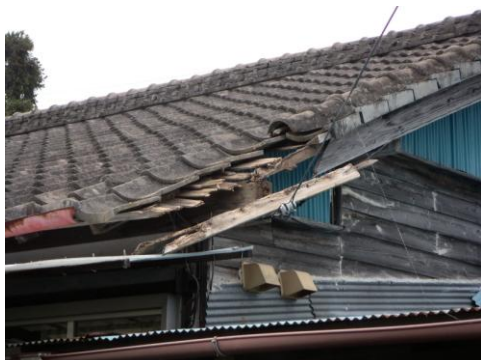
写真 2-14 屋根瓦の落下損傷 (B ランク)
