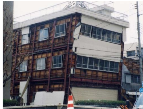
写真3-3 傾斜による外装材の剥落
