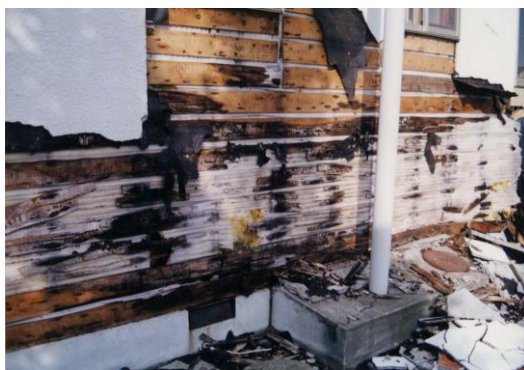
写真 2-12 下地材の腐朽 (B ランク)
