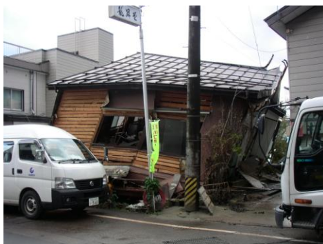
写真 2-3 隣接する建物の傾斜(Cランク)
