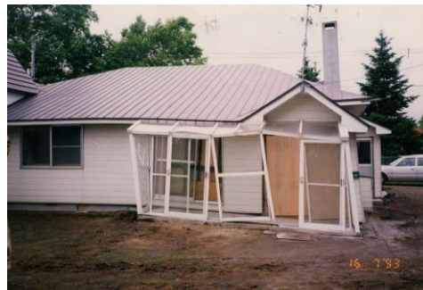
写真 2-6 建物の不同沈下(Cランク)
