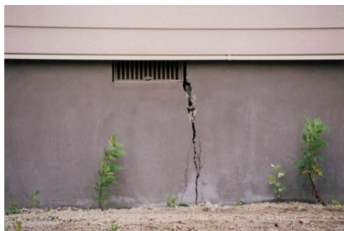
写真 2-7 基礎の亀裂(Bランク)
