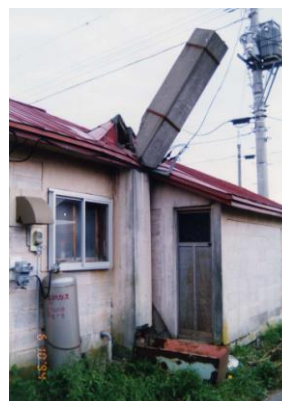
写真 2-25 煙突の転倒危険(Cランク)
