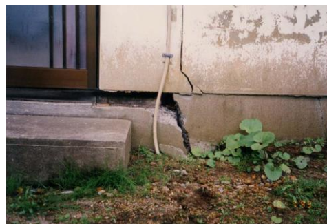
写真 2-8 基礎の破断(Cランク)
