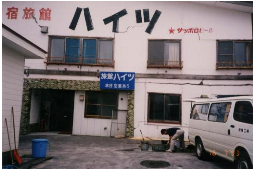
写真 2-10 外壁の被害 (B ランク)
