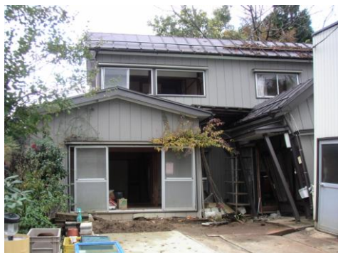
写真 2-16 窓枠の歪み (B ランク)
