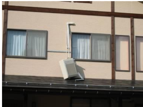
写真 2-22 エアコン室外機の落下危険(Cランク)
