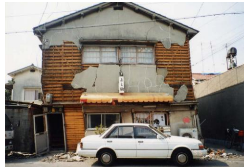
写真 2-11 外壁の被害 (C ランク)
