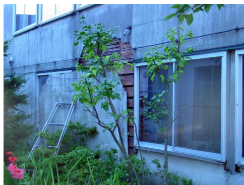
写真 2-19 モルタル壁の剥落 (B ランク)
