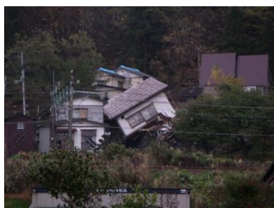
写真5-1 隣地に被害を及ぼした宅地
