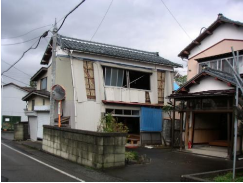
写真 2-20 サイディングの落下(Cランク)
