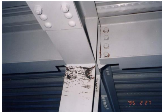
写真 3-4 柱頭の座屈による塗料の剥落 (B ランク)
